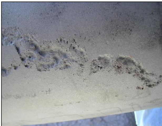
Fig. 1 –La limpieza hecha en esta línea reveló más daño que fue visible durante la inspección inicial. La limpieza adecuada es esencial para una buena reparación y un excelente desempeño. Las picaduras de corrosión que se observan deben ser rellenadas con WrapFill 811™ .
