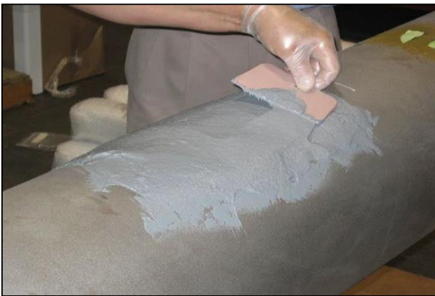
Fig. 4 –El defecto debe ser llenado completamente con masilla de relleno debe ser nivelada a la superficie.
